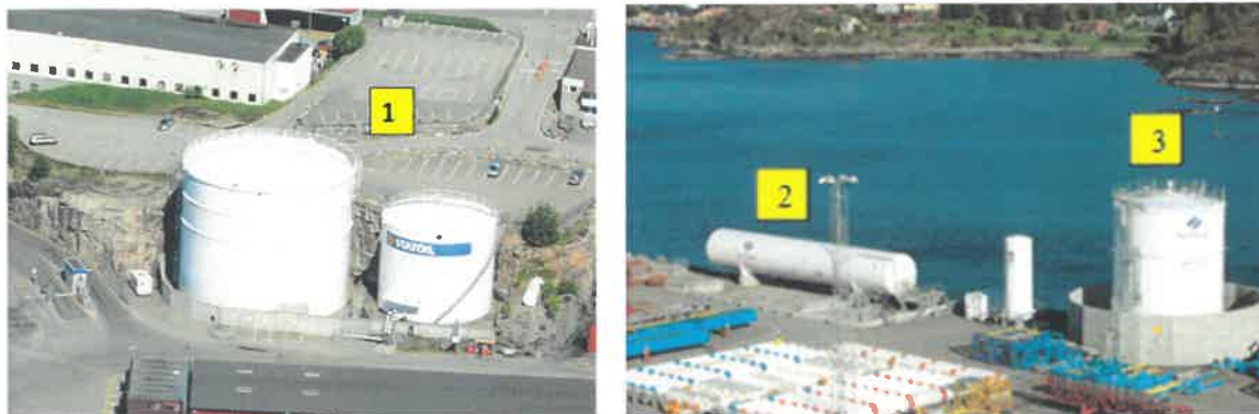
Figur 1 og 2 Bilde av hhv. MGO tanker (1) LNG tank (2) og Metanoltank (3)
