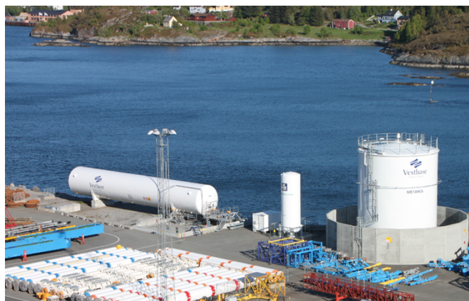
(LNG og Metanoltank på Vestbase)
