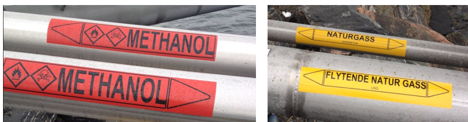
Figur 20 – Bilde typisk merking av rørledninger
